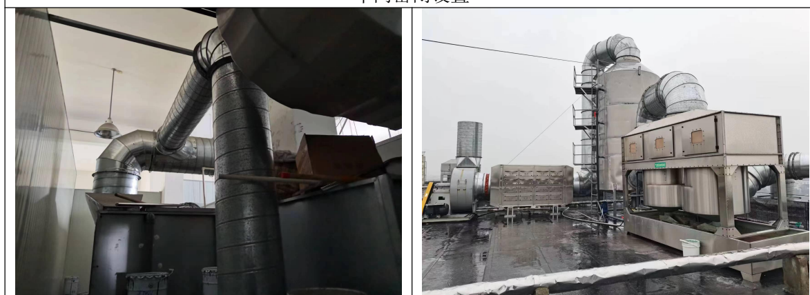
废气收集管道
