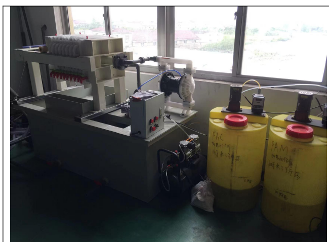
废水处理设施
