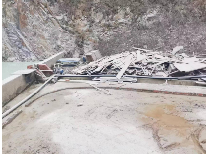
废水提升输送管线
