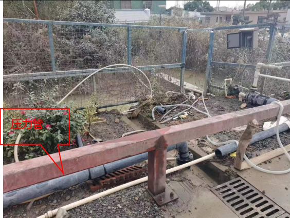
蓄水池、提升泵
