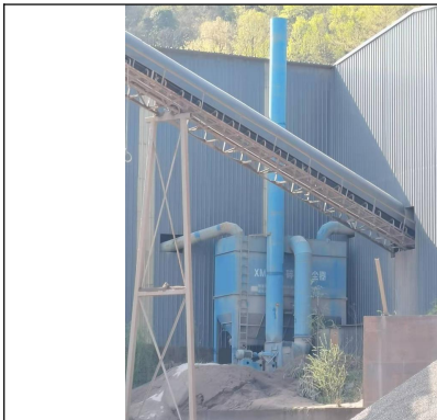
布袋除尘器及 15m 高排气筒
